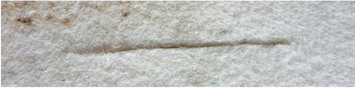
Mantilla deteriorada. Detalle
